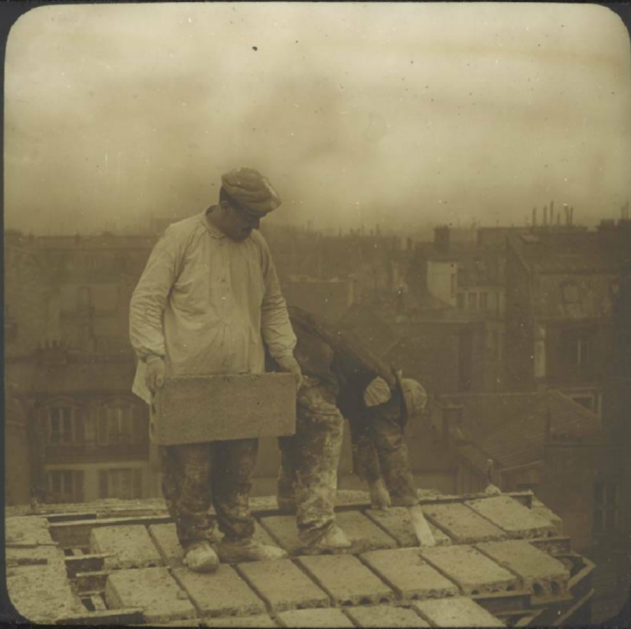
23 Commencement de construction - un ouvrier pose des planches, l'un des briques neuves
