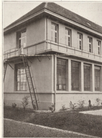
Les balcons en ciment armé et les échelles de fer pouvant servir de dégagement en cas d'incendie. Tous les bâtiments possèdent ce dispositif de sécurité.
